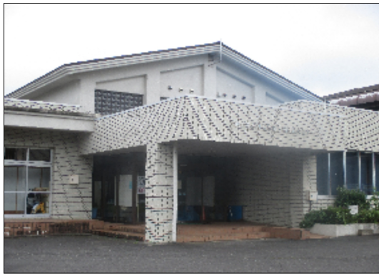
放置される保健センター雨漏り、修繕し児童クラブの活用が待たれる。
